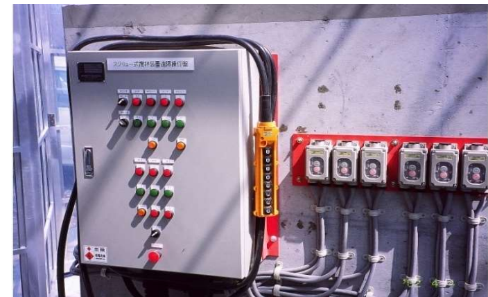
操作盤・遠隔装置
